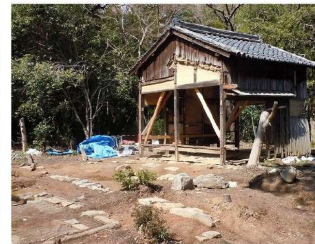
北北棟（左側は発掘調査で検出された玄関棟と北棟の礎石）
